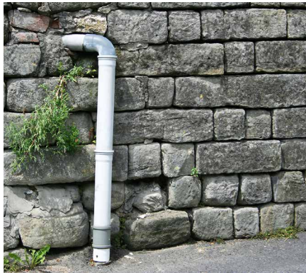
4.1.1 Vor der schön gesetzten Quadermauer steht leider unschön ein Abwasserrohr, das besser hinter die Mauer gehört hätte.
