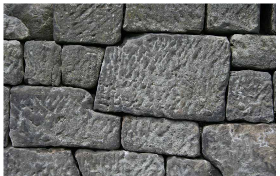
2.3.21 Detail einer hammerrechten Schichtenmauer. Was nicht genau zusammen passt, wird passend gemacht.
