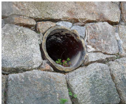
4.1.3 rechts Ein Fremdkörper bleibt diese Vermessungsmarke an einer Natursteinwand.
